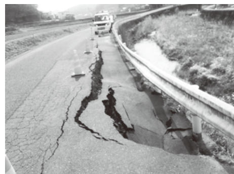
新たに護岸崩壊が発生した同市道
